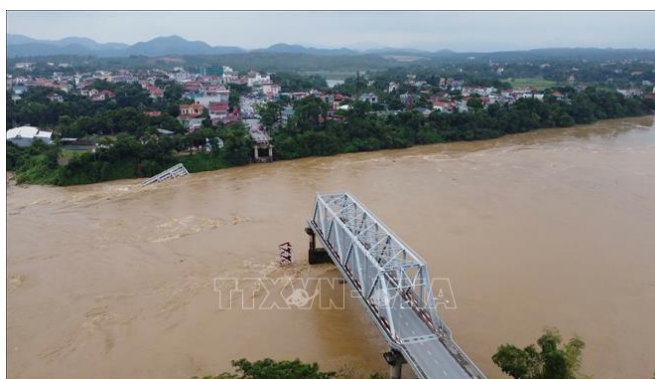
Cầu Phong Châu (Phú Thọ) bị sập, sáng 9/9. Ảnh: Tạ Toàn/TTXVN
